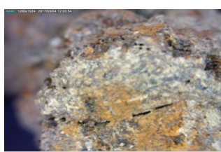
شکل ۱۸. ترک موازی با سطح Figure. 18. Crack parallel to the surface
