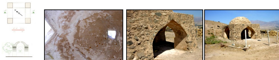
شکل ۳. از راست؛ آتشکده الزین (دید از جنوب)، نمای نزدیک از یکی از طاق‌ها، نمای داخلی گنبد و روزنه بالای آن؛ پلان بنا (نجفی، ۱۳۸۶)
