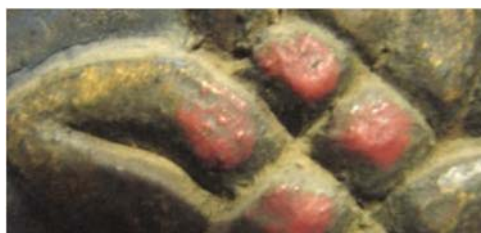
شکل ۳: تصویر با بزرگنمایی از کتیبه‌ی سنگی مذکور. تزئینات طلاکاری و رنگ‌آمیزی در زیر لایه‌ای از آلودگی قابل مشاهده است.
