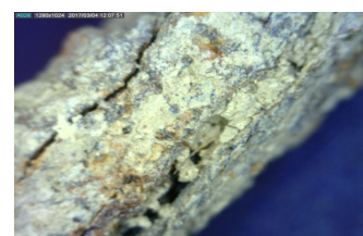
شکل ۱۶. شکاف‌های موجود در سطح Figure. 16. Cracks in the surface
