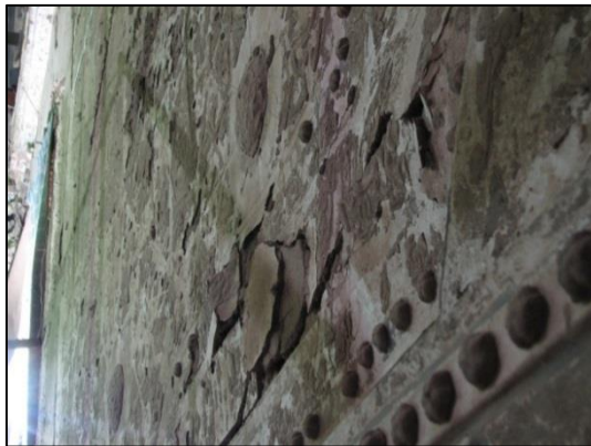
شکل ۳: فرسوده شدن و از بین رفتن بخش های زیادی از لایه آستر و شکستگی، ترک خوردگی و ریختگی بخش هایی از لایه بستر و ضعف اتصال آرایه های گچی قالبی به زمینه بستر
